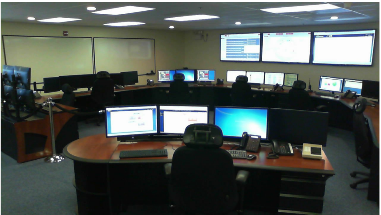
Figure 3 – Actual Control Room
